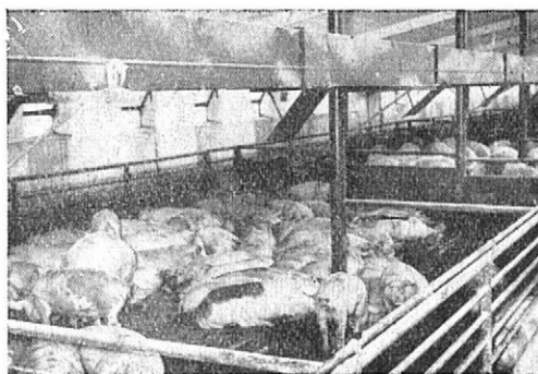
6. Směrování výustek vzduchovodu. V letním období směřuje proud vzduchu do lože
