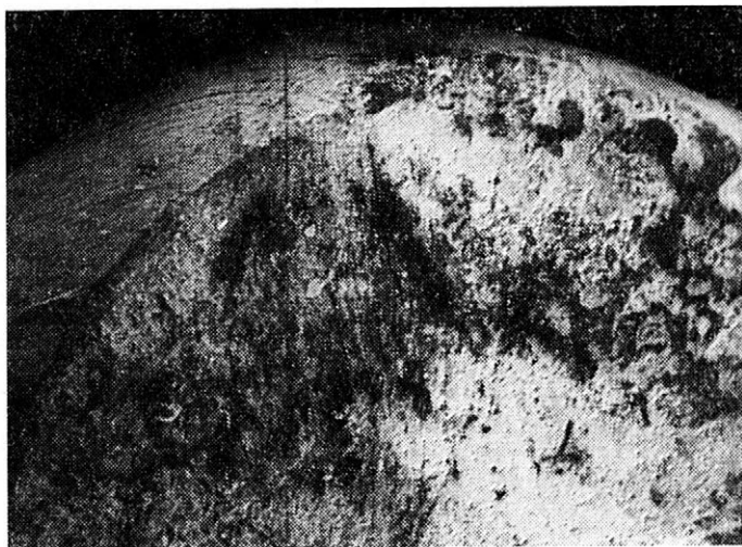
6. Detailní část snímku pevného kontaktu vzduchového stykače opáleného elektrickým obloukem — Enlarged part of the photograph of the rigid contact of an air-break contactor burnt by electric arc
