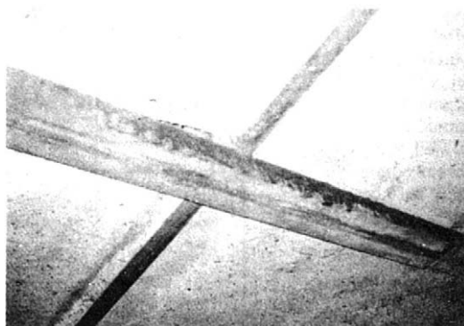
8. Pohľad na vlhkosťou znehodnotený drevený nosník podhľadu – View of wooden carrier damaged by moisture from bottom view
