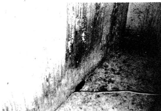
11. Znečistenie vencovky a obvodovej steny od stekajúceho kondenzátu – Contamination of ring beam and peripheral wall from running down condensate
