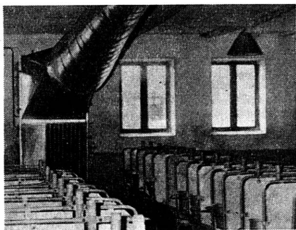
4. Detail rozvodného foliového vzduchovodu z polyetylenového kaširovaného materiálu agrofoll v profylaktoriu na farmě Svinňý-Chotěboř jako součást rekuperačního výměníku tepla – Detail of distribution foil air conduct made of polyethylene backed material called agrofoll in prophylactic room on the farm Svinňý-Chotěboř as a part of recuperation heat exchanger
