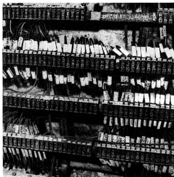
2. Koroze hlavní svorkovnice elektrického rozvaděče v objektu živočišné výroby po šesti měsících působení stájeového ovzduší; předpokládaná životnost 10 roků; skutečná 4 roky
