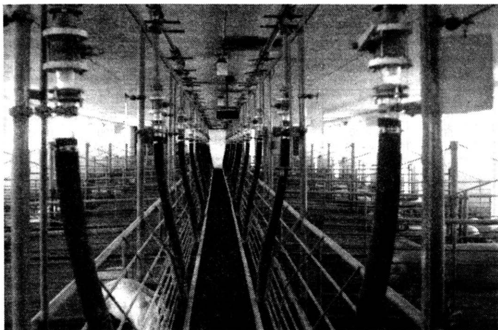
3. Celkový pohled na instalovanou linku pro potrubní krmení s velkoplošným displejem ve stáji pro odchov prasniček na farmě v Podboří – The general view of the installed line for pipeline feeding with large area display in the stable for gilt rearing on the farm at Podboří
